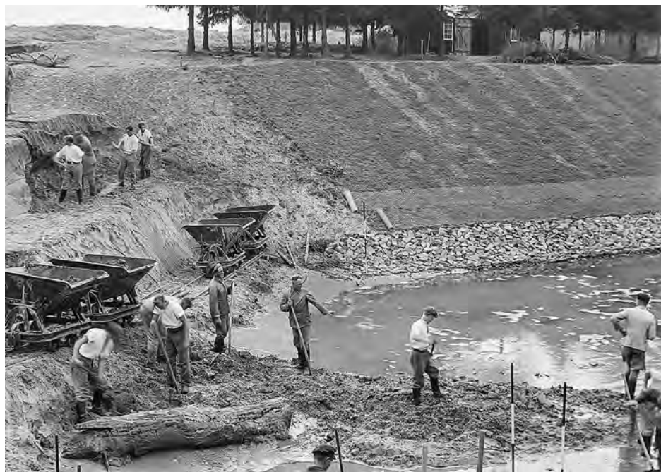
Abb. 2: Der ›Freiwillige Arbeitsdienst‹ bei Bauarbeiten zur Emsregulierung bei Greven 1934 Fotosammlung Hermann Reichling, © LWL-Medienzentrum für Westfalen
